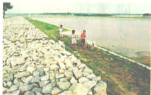
地处黄河河道的河南省台前县河务局职工已进入战备状态，昼夜巡堤查险、确保黄河安澜。近几年黄河流域雨量偏枯，小水期时间长，河床严重淤积，地上悬河急剧上升，黄河防汛形势十分严峻。这是备足抢险石料的临黄49公里大堤47处险点险段。
